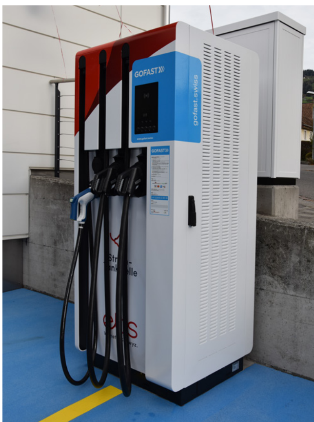
Schneller am Ziel: Die ebs Energie AG hat drei Schnellladestationen in ihrem Stromtankstellennetz.
