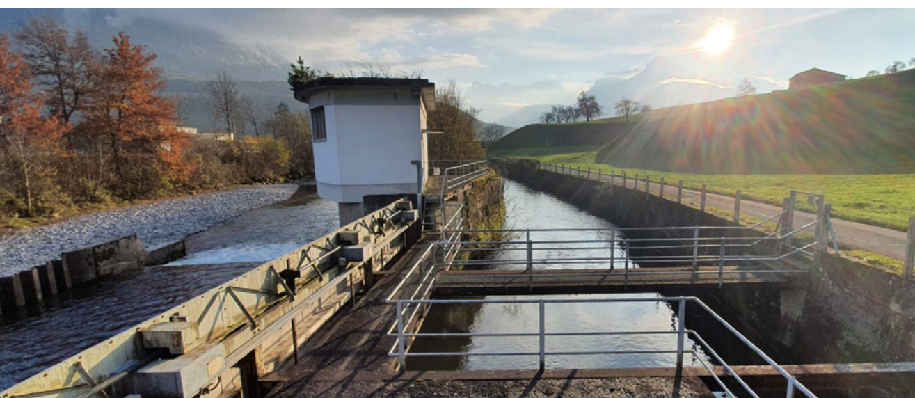
Zurück zur Natur: das stillgelegte Kraftwerk in Brunnen wird zurückgebaut und die Muota revitalisiert.
