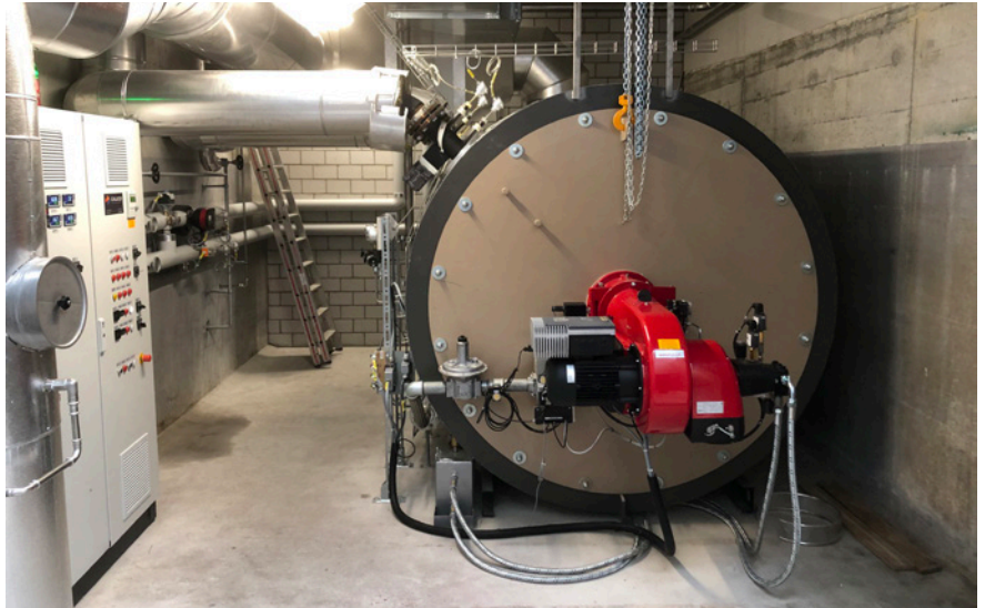
Der neue Thermokessel bei der Reichmuth Fleischwaren AG in Schwyz.
