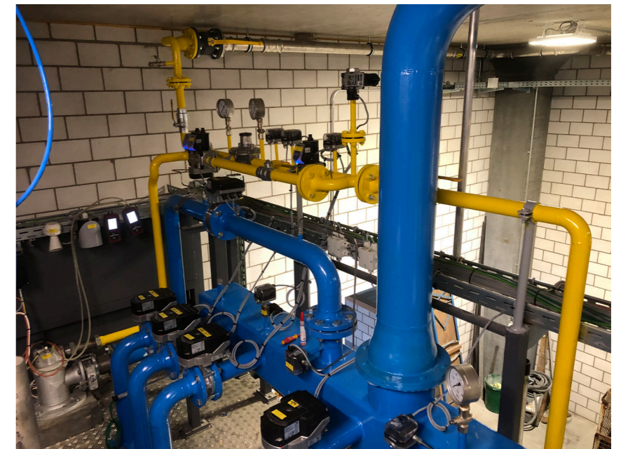
Anlage eines Prozessgaskunden
