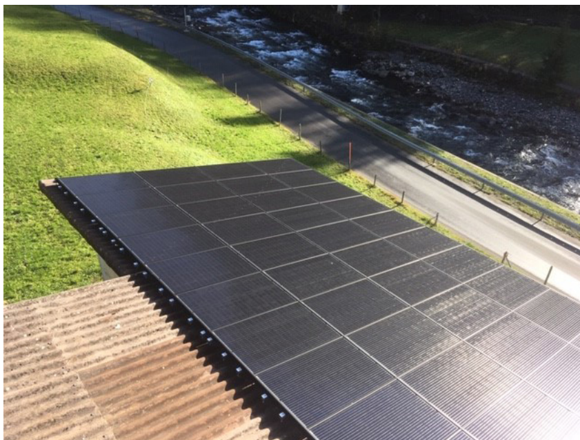
Photovoltaikanlage auf dem Dach vom Stützli 4 in Muotathal
