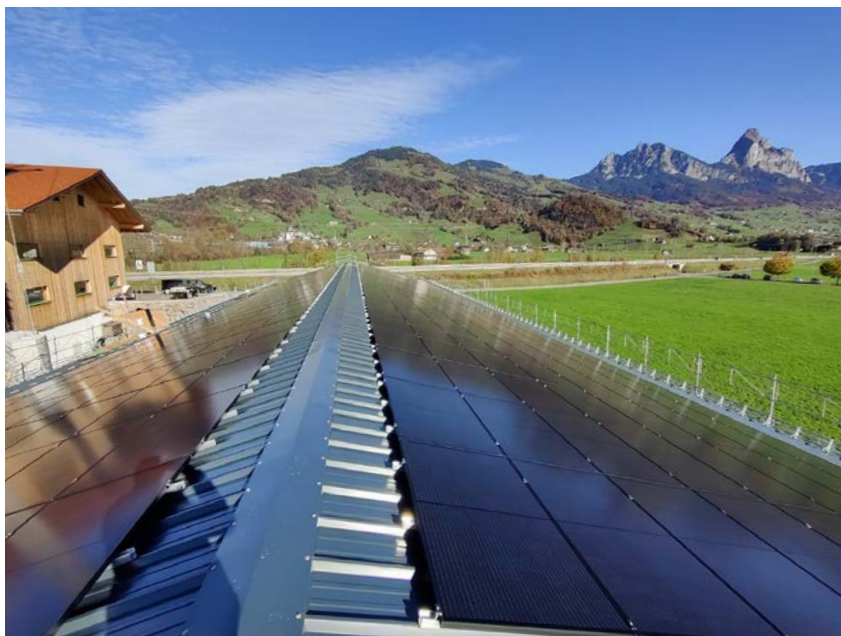
ebs-Solarkraftwerk auf dem Hundeausbildungszentrum in Steinen
