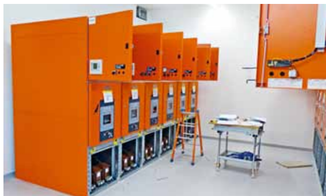
Die Inneneinrichtung der neuen Unterstation Petersboden (Oberberg) wird 2015 fertiggestellt.
